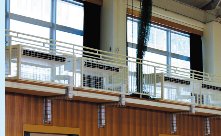
体育館に設置された室内機
