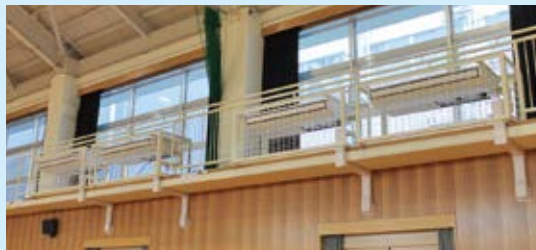
空調設備の室内機
