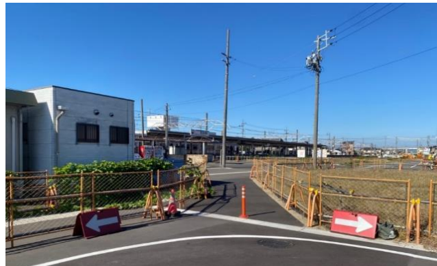
写真8 (暫定通路) 鉄道高架工事着手後、使用不可の可能性あり
