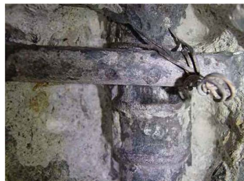
⑥鉄筋の腐食（さび）の状況
