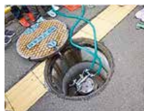
地下式給水栓
