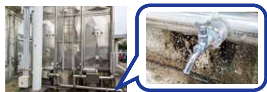
春日小学校受水槽
