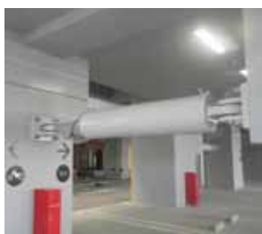
庁舎北館の免震ダンパー
