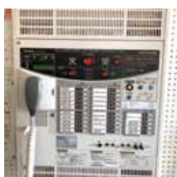
非常用放送設備
