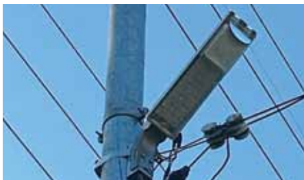
LED化された公園灯 (西須ヶ口公園)
