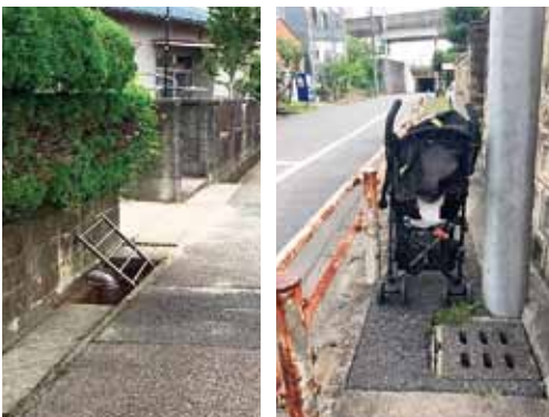
側溝の蓋がない道路や幅の狭い歩道
