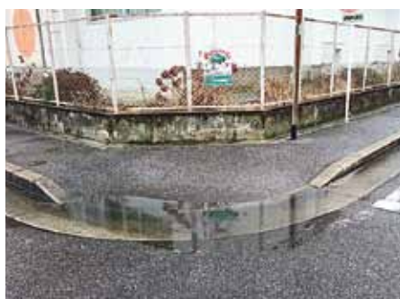
星の宮小学校体育館角の水溜り
