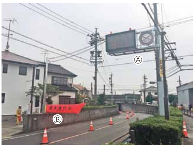
①情報表示板(LED化更新) ②バルーン式仮封鎖装置
