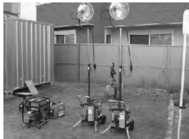
投光機・発電機
